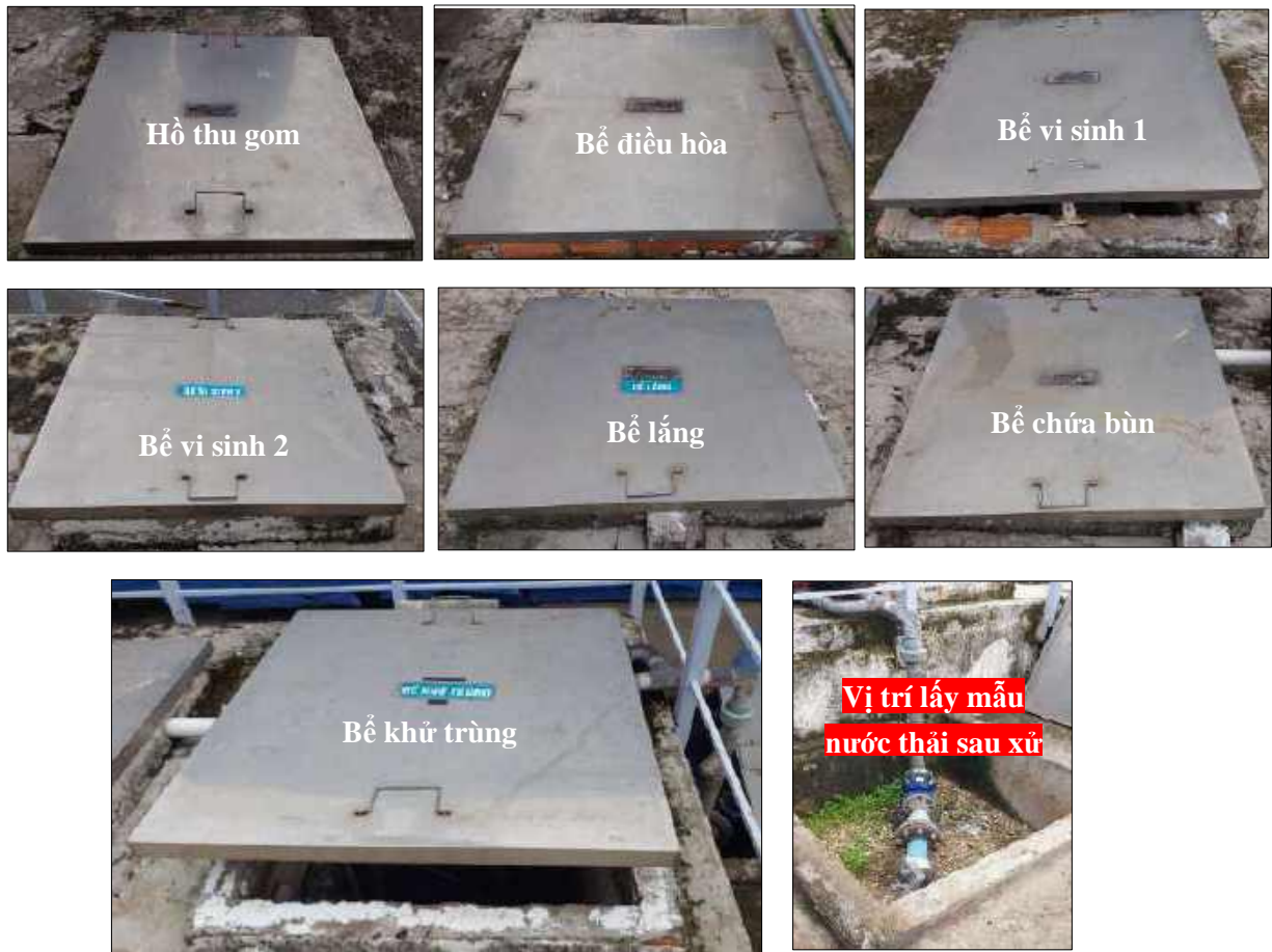
Hình 3.7. Một số hình ảnh tại khu vực HTXLNT của cơ sở
