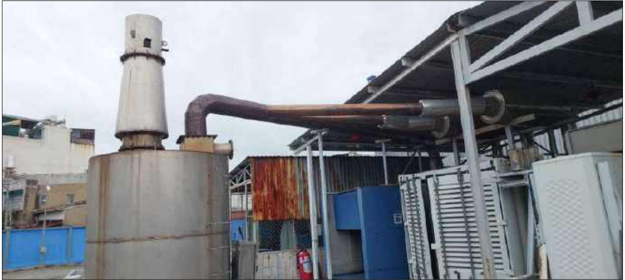
Hình 3.9. Hệ thống xử lý khí thực tế tại cơ sở
