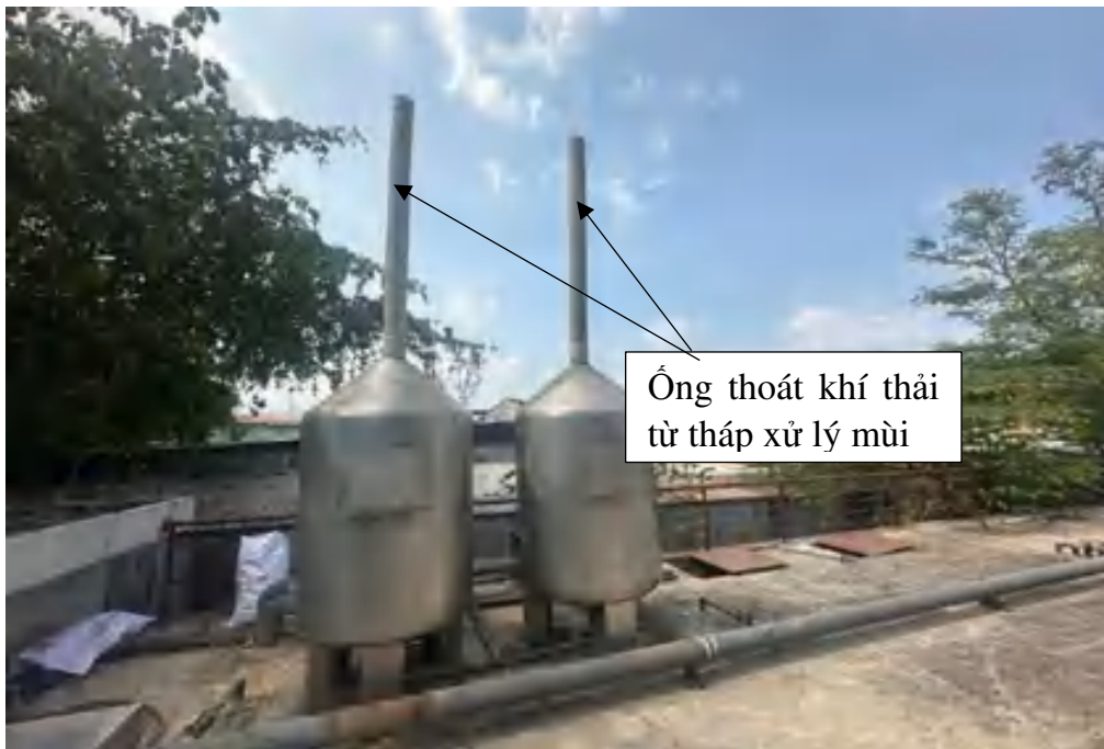
Hình 3. 10 Ống thoát khí của tháp xử lý mùi tại khu vực phòng điều hành của HTXLNT
