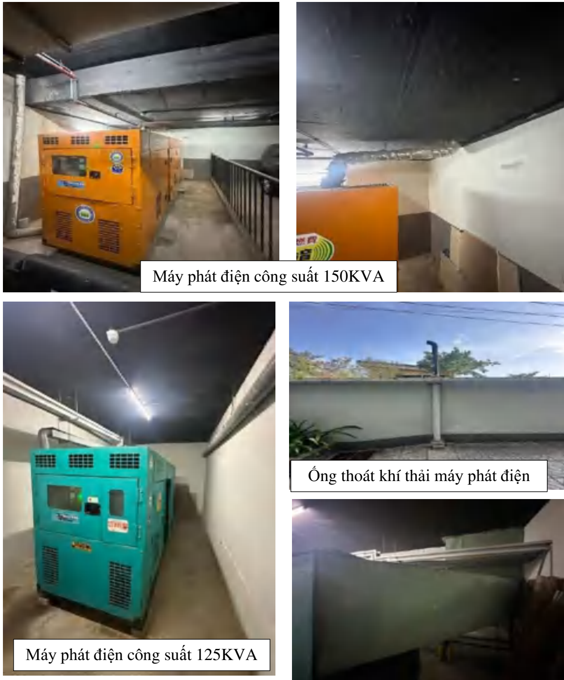
Hình 3.13 Khu vực máy phát điện
