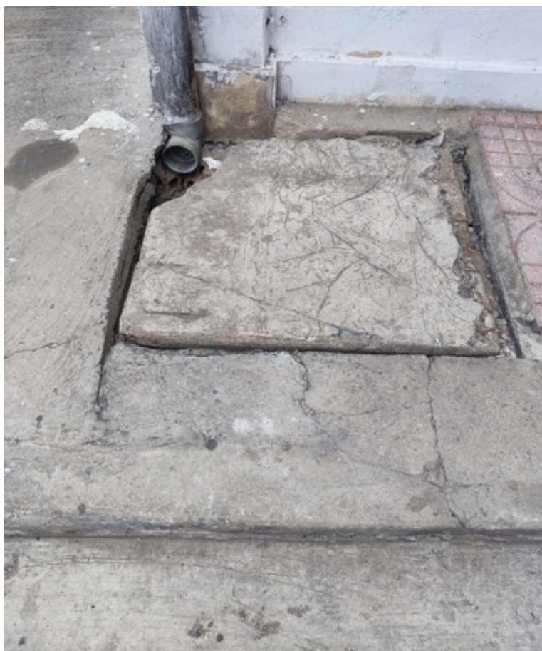
Hình 3. 2. Hình ảnh hố ga thu gom thoát nước mưa bên trong cơ sở
