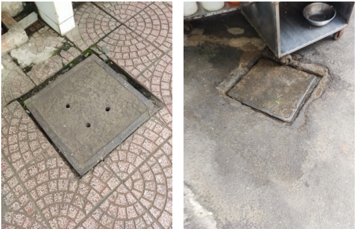
Hình 3. 4. Hình ảnh đường ống thoát nước thải sau xử lý và hồ ga thoát nước bên trong cơ sở
