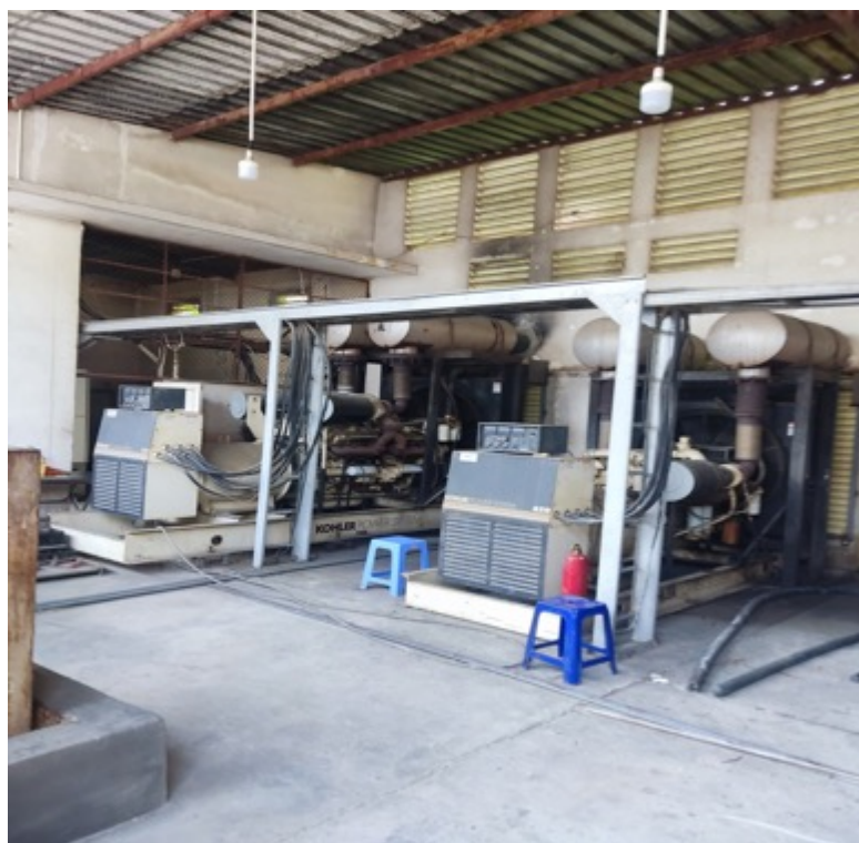
Hình 3. 19. Hình ảnh khu vực máy phát điện dự phòng
