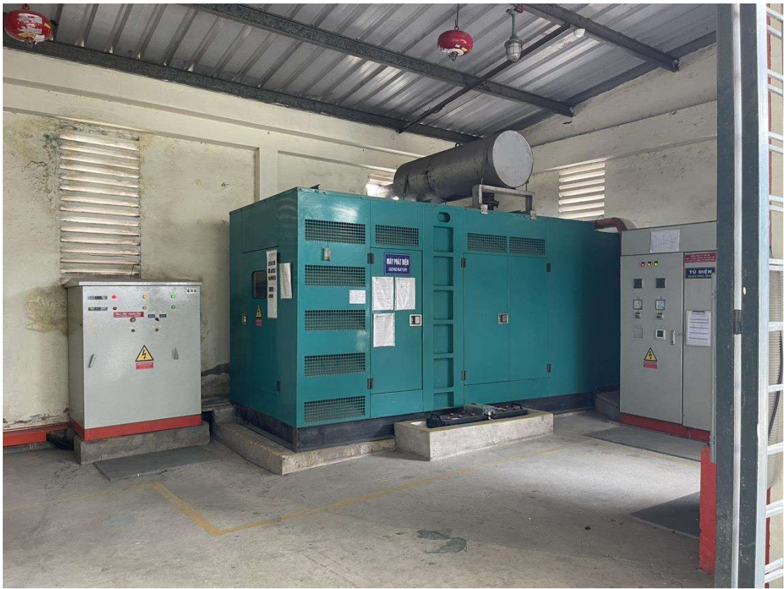
Hình 3.7. Khu vực máy phát điện
