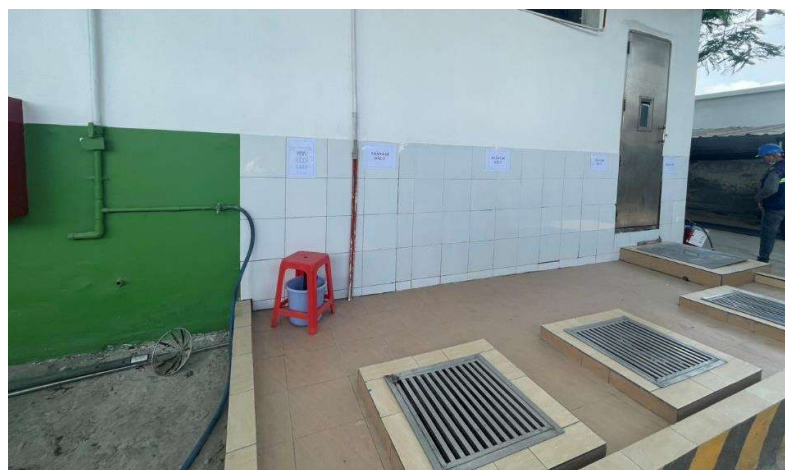
Hình 3.4. Bể tách dầu mỡ
