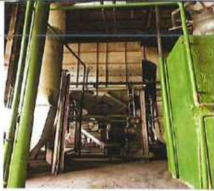
Bể đập bụi (lò 1)
