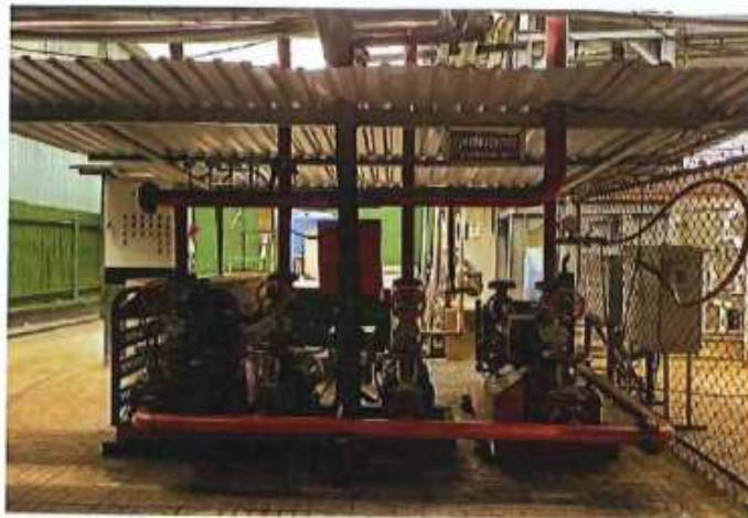
Các công trình PCCC
