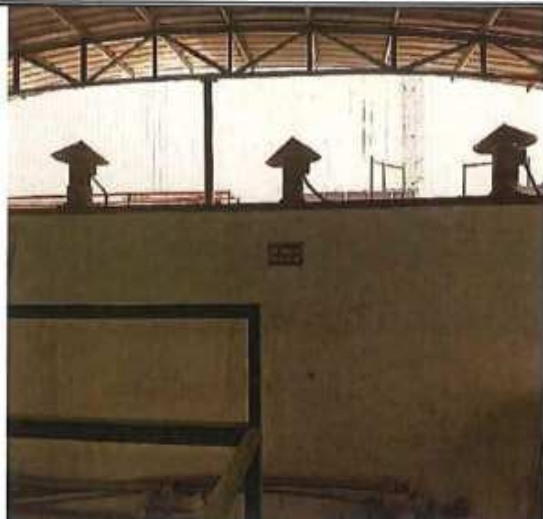
Bể điều hòa
