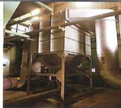
Bể đập bụi (lò 2)
