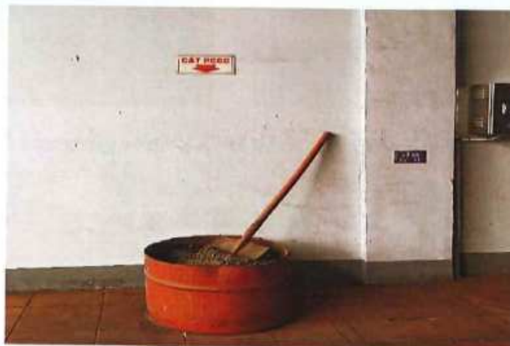
Hình 1.13. Hình ảnh công trình PCCC của Cơ sở
